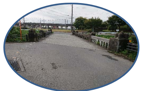
旧館林道(日光脇往還) (旧中山道鴻巣宿・追分近く) 土木遺産・堀切橋
